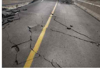
도로 아스팔트 균열
