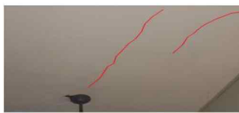
<천장 슬래브 균열>
