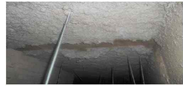
<보 단열재 탈락>
