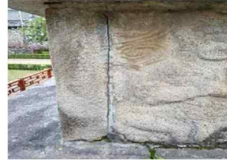
문화재 운문사 균열
