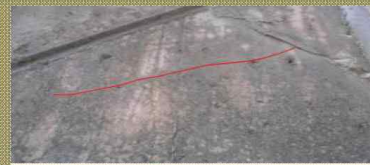
<콘크리트 옹벽 사선균열>
