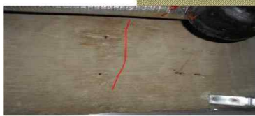
<보 측면 균열>
