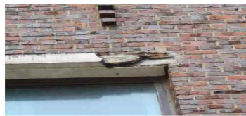
<인방 미장 탈락>
