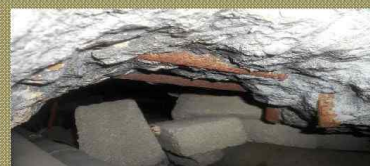
<콘크리트 벽체 철근노출>
