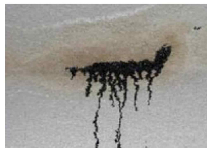
구조체 균열부위로 용제형 방수재 흘러내림
